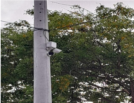
Cámaras de seguridad parqueadero
